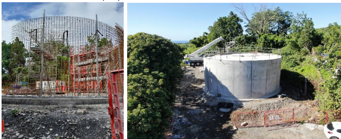
Figure 1 : Réservoir associé au Forage le DESERT
